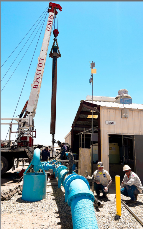
Los técnicos de operaciones Brian Toner y Darren Dykes asisten con las reparaciones en el pozo 8.
